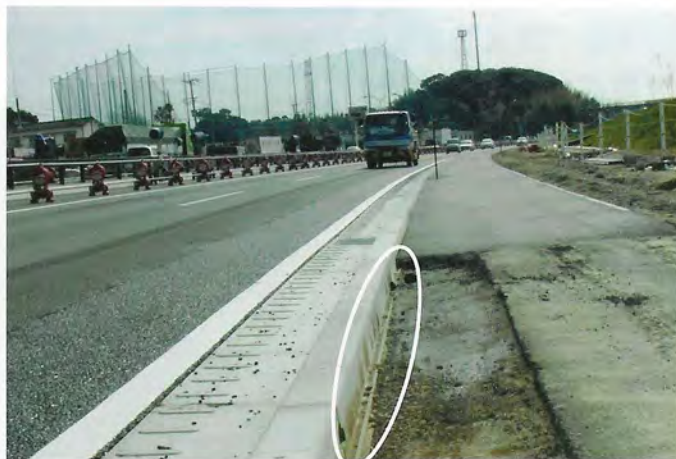
舗装前の状況（下部に凸部が確認できます）
